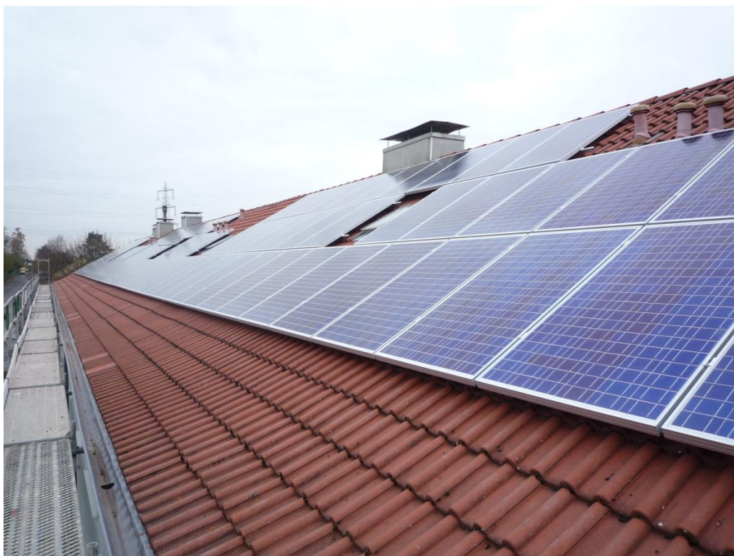
Erste Solaranlage in der Castorffstraße, Schwelm
